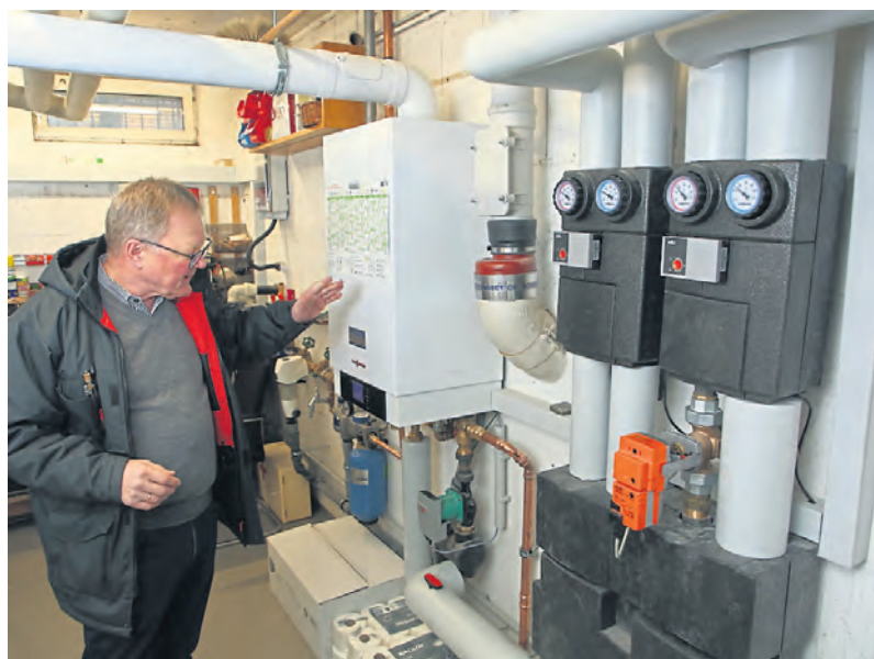
Eine neue Gasbrennwertheizung sorgt nun im Pfarrheim für die passende Wärme in allen Räumen.
